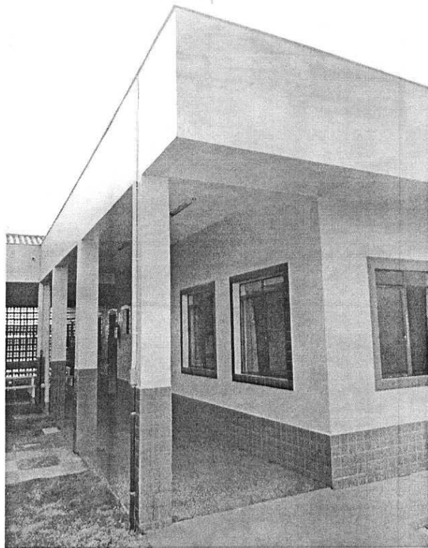
Cobertura e abertura - telhas em fibra de vidro - Abertura porta de girar e maxin ar
